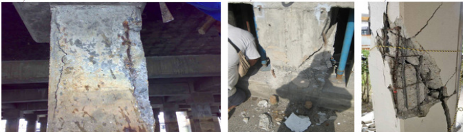
Hình 1. Kết cấu cột BTCT bị phá hoại [1]
